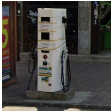
46. ábra "A" típusú elektromos autótöltő Szekszárdon
