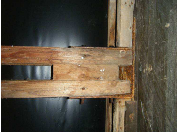
5. sz. kép : az acél szerelvények korrodáltak
