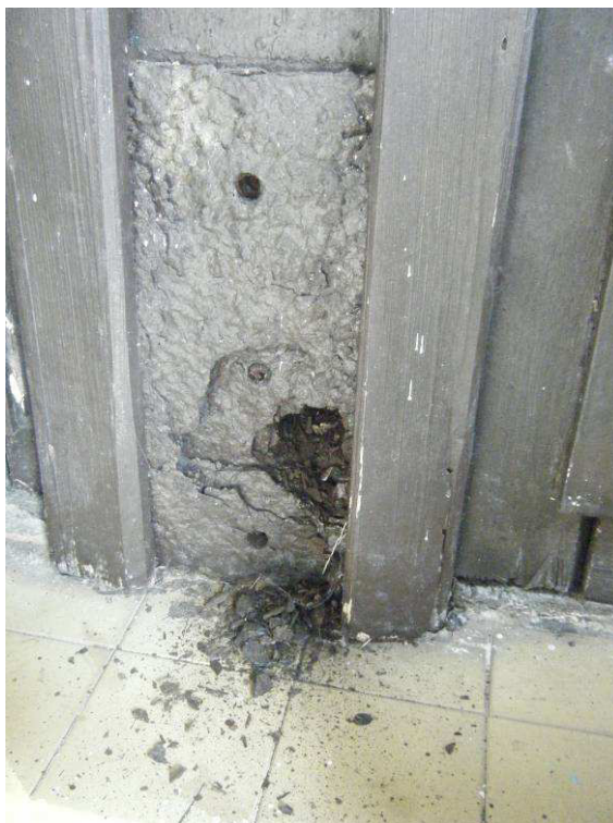
7. sz. kép : a talpcsukló teljesen korrodált
