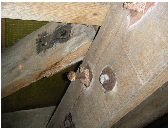
8. sz. kép : a csavaros kötések kilazultak
