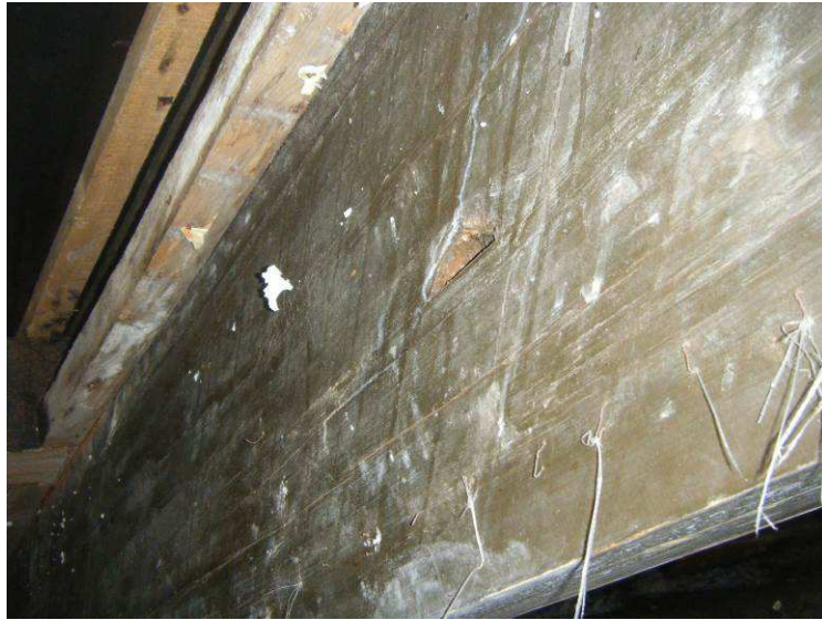
1. sz. kép : a főtartón kb. 1-2 cm mély száradási repedés
